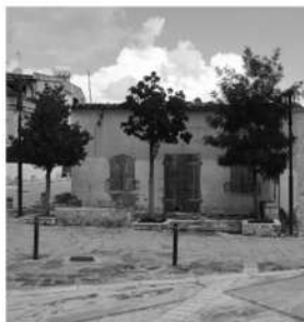
Ασυντήρητη και εγκαταλελειμμένη οικοδομή
